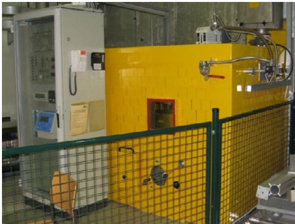
Рис. II.2.9. Общий вид пневматической транспортной установки и стойки управления (прототип)
